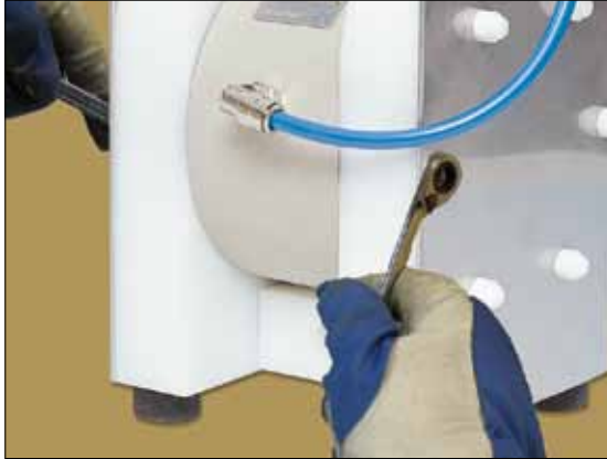
Fig 1. Débrancher le tuyau d'air entre le booster et la pompe.
